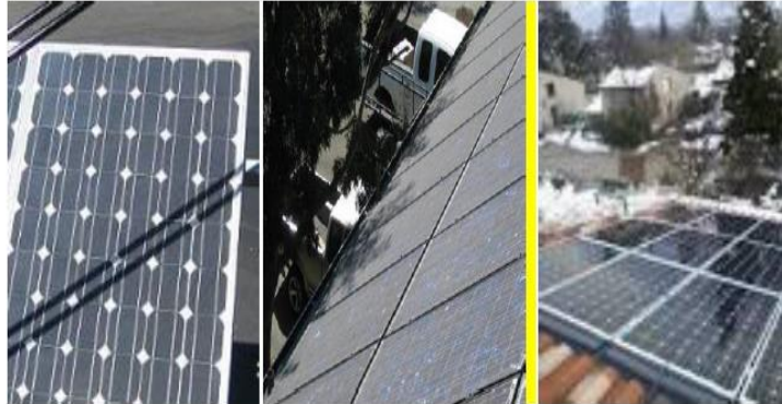
Figure IV.4 : Défaut d'ombrage partiel
