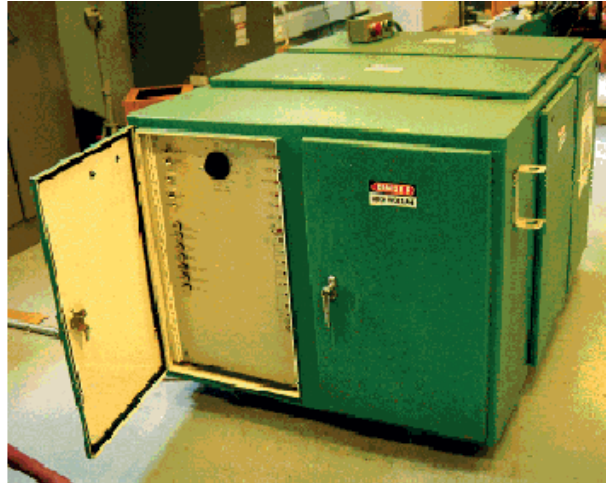
Figure I.3 : Banc de condensateurs pour le stockage d'énergie
