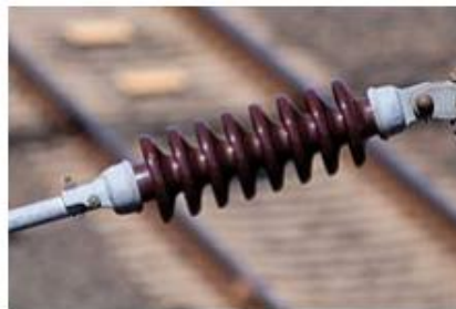
Figure 1.2 Isolateur céramique utilisé pour supporter les câbles hauts tension.
