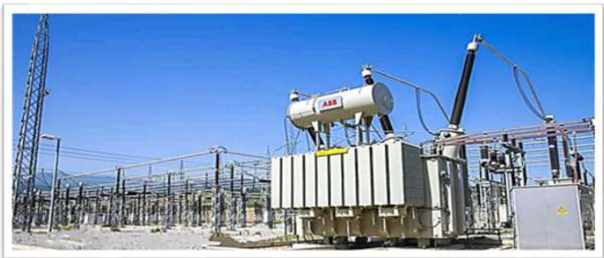
Figure I.9 : Sous-station électrique (MRSS).
