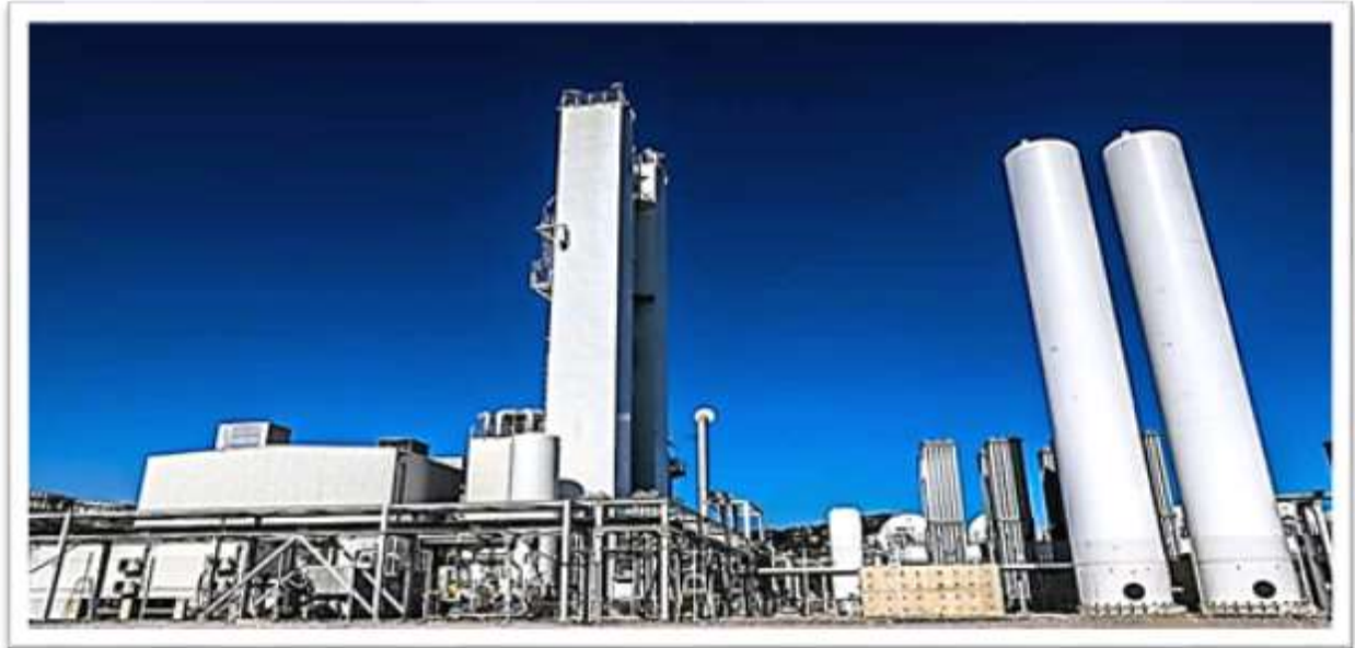
Figure I.5 : Unité de séparation d'air (ASU).
