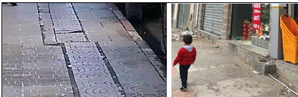
Figure33: Etat du revetement de sol.
