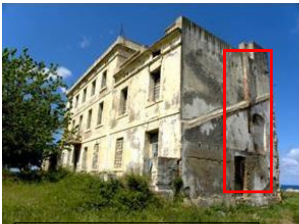
Figure 67: dégradation de la façade Source: personnelle
