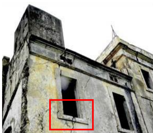
Figure 68: fissures importantes sur le mur Source: personnelle
