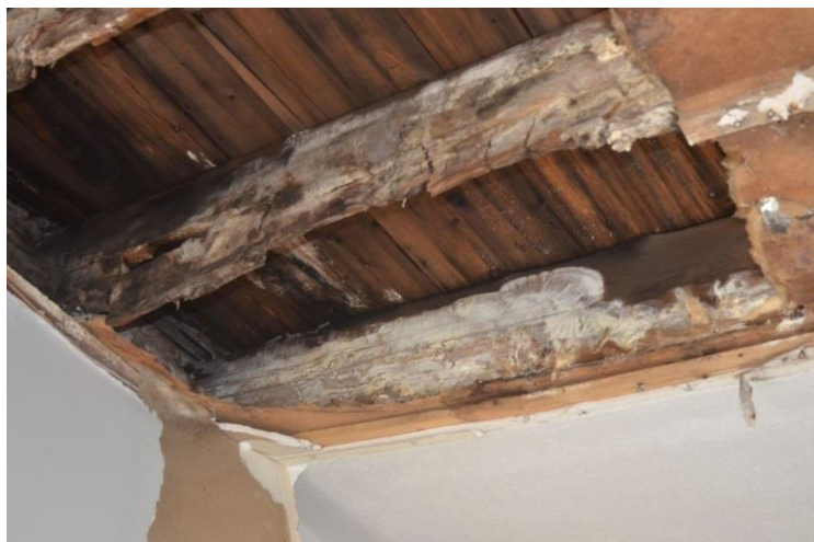
Figure 13: Pourrissement d'un plafond en bois, Source: bebexperts.com (consulté le 04/05/2021)
