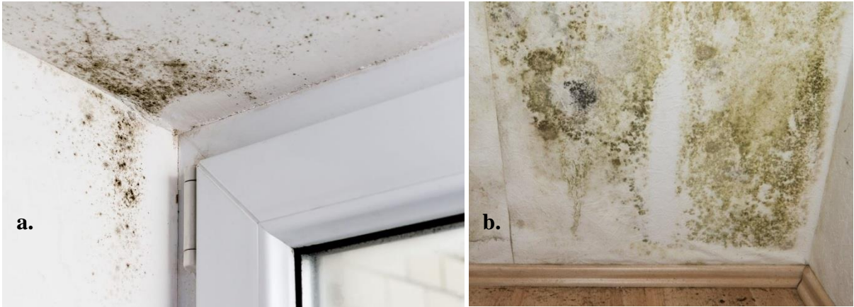
Figure 11: Moisissures et champignons sur les murs et le plafond, Source: a. www.linternaute.fr , b. www.humidite-expert.fr (consulté le 04/05/2021)
