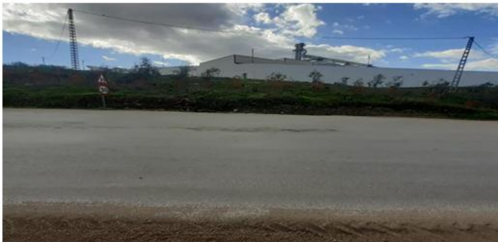
Figure III.04: déformation de la chaussée et bourelet au pied de talus.
