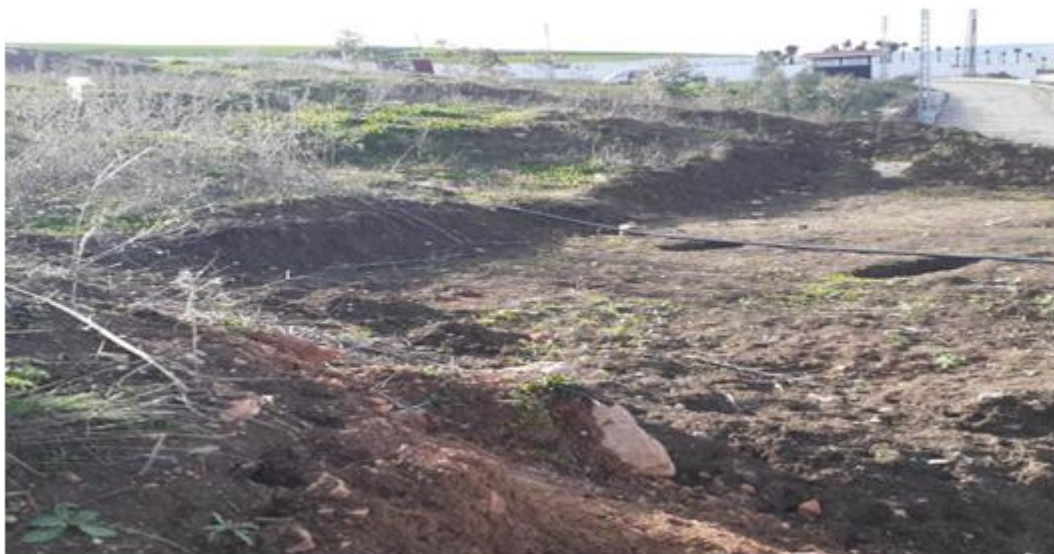
Figure III.02: La nature argileuse du terrain et apparition d'escarpement en haut du talus.
