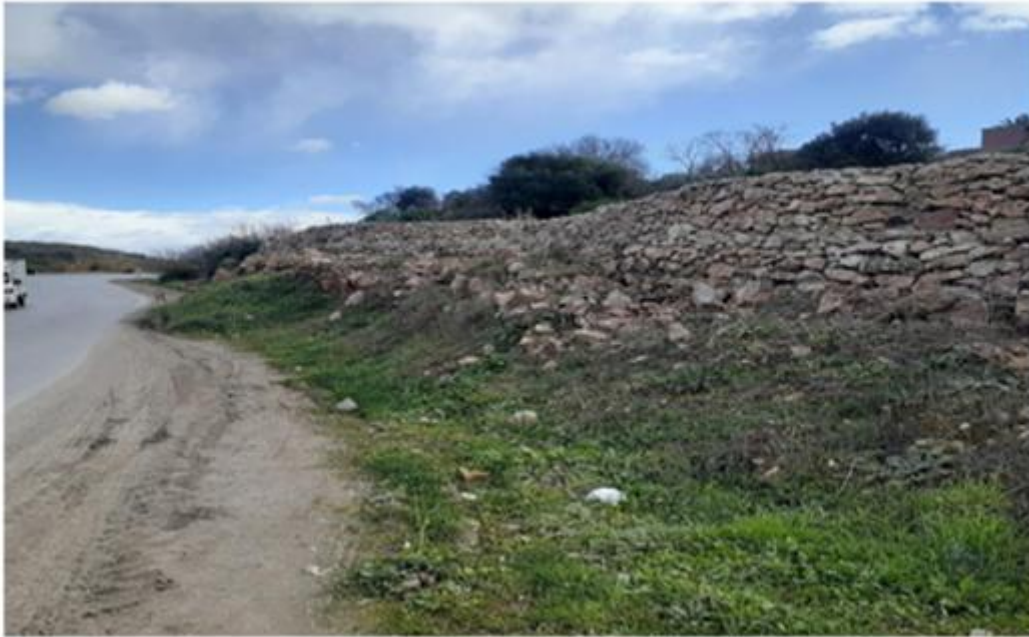
Figure III.03: MVT gabion au pied du talus dû aux poussées des terres.
