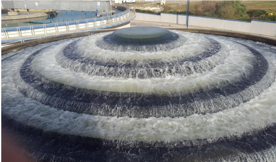
Figure (I.5) : Cascade d'aération.
