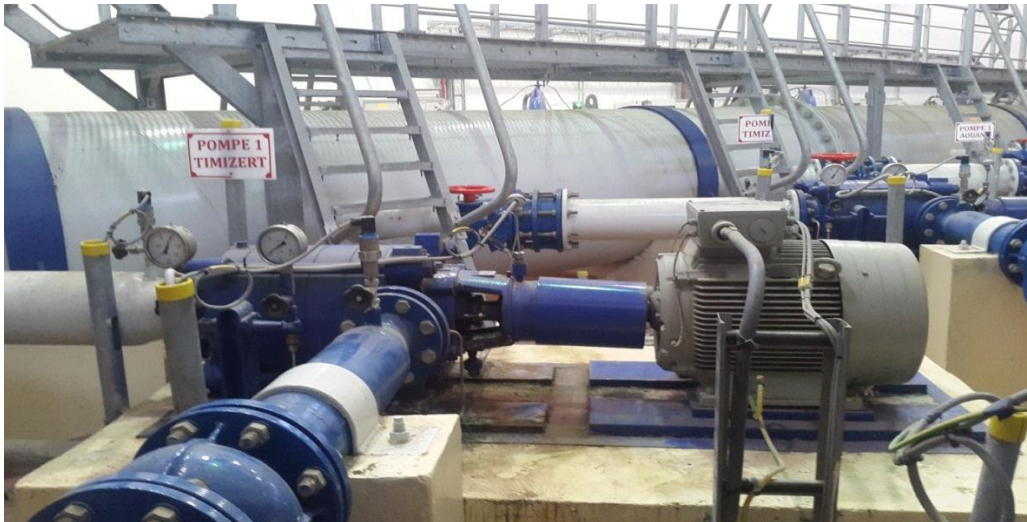
Figure (I.11) : Groupe de pompage Timizert.
