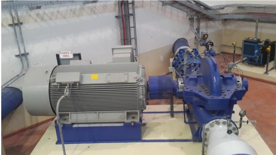
Figure (I.12) : Groupe de pompage d'Ouled Bounnar.
