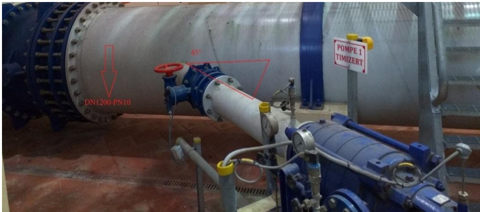
Figure (I.9) : Collecteur d'aspiration de la station de pompage.
