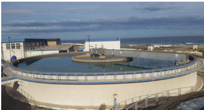
Figure (I.7) : Clarificateur.
