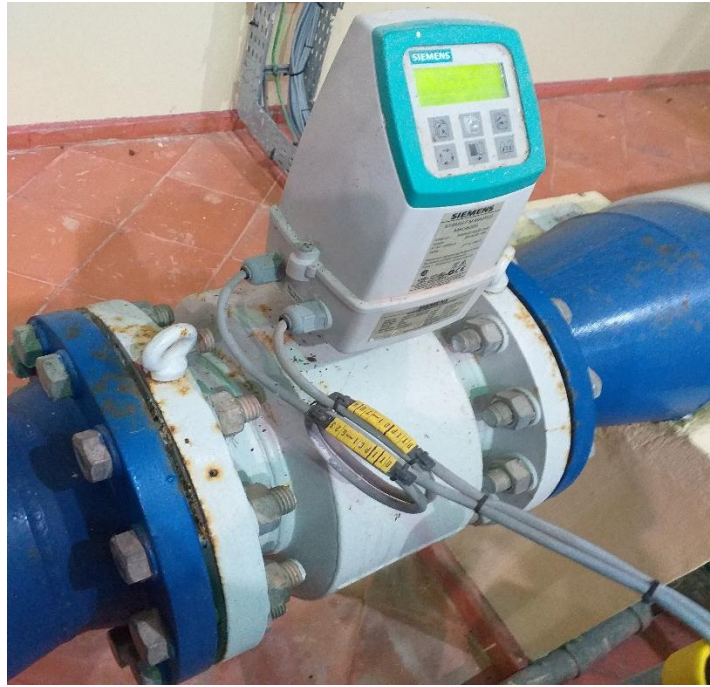
Figure (V.7) : Installation du débitmètre électromagnétique sur le refoulement.
