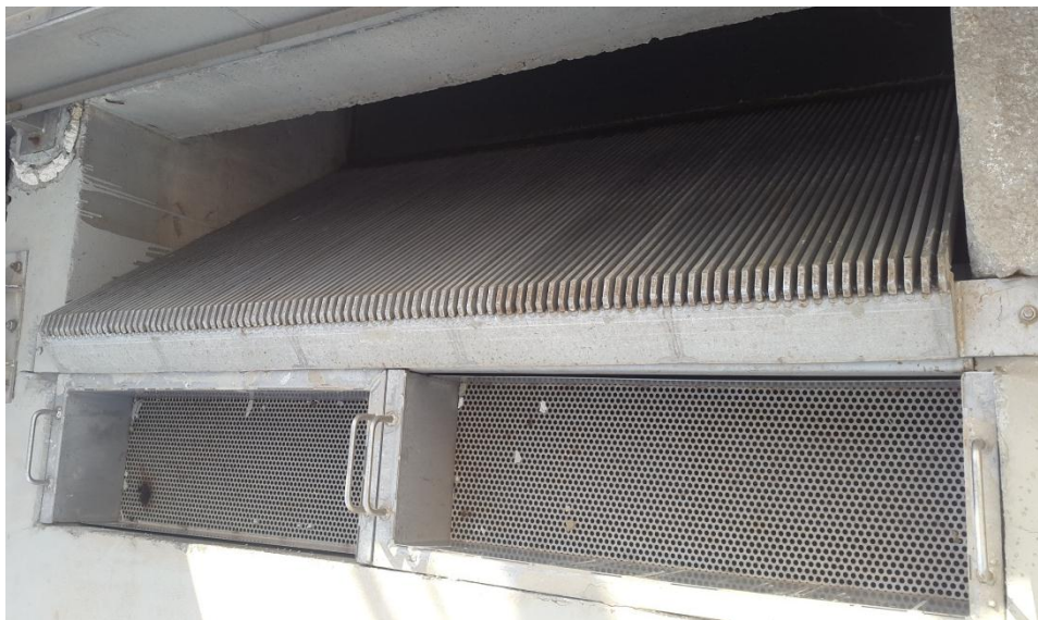
Figure (I.4) : Dégrilleur.
