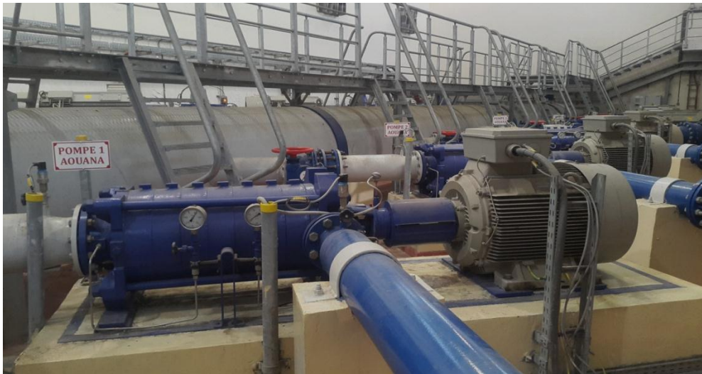
Figure (I.10) : Groupe de pompage EL-Aouana.
