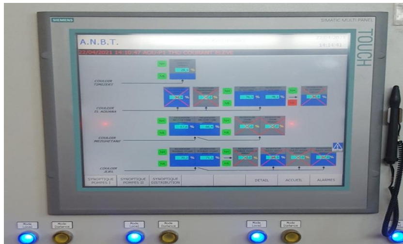
Figure 1.20 : Pupitre de supervision du système de remplissage des eaux traitées (station de traitement des eaux de Kissir).
