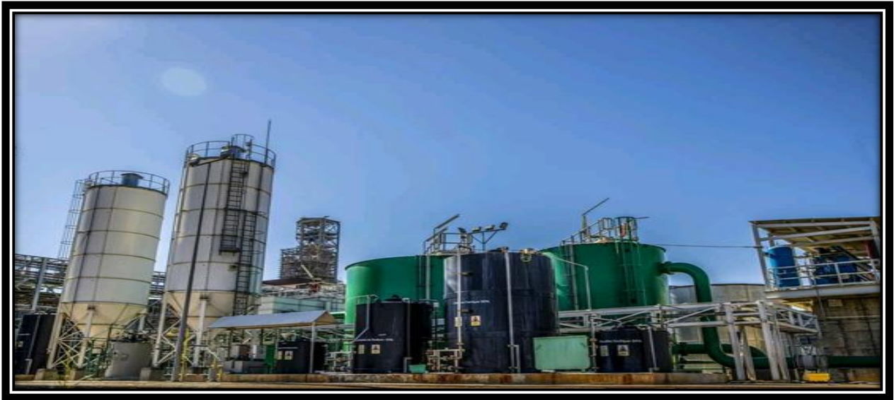
Fig.15. Station générale de traitement des eaux (WTP) [3]
