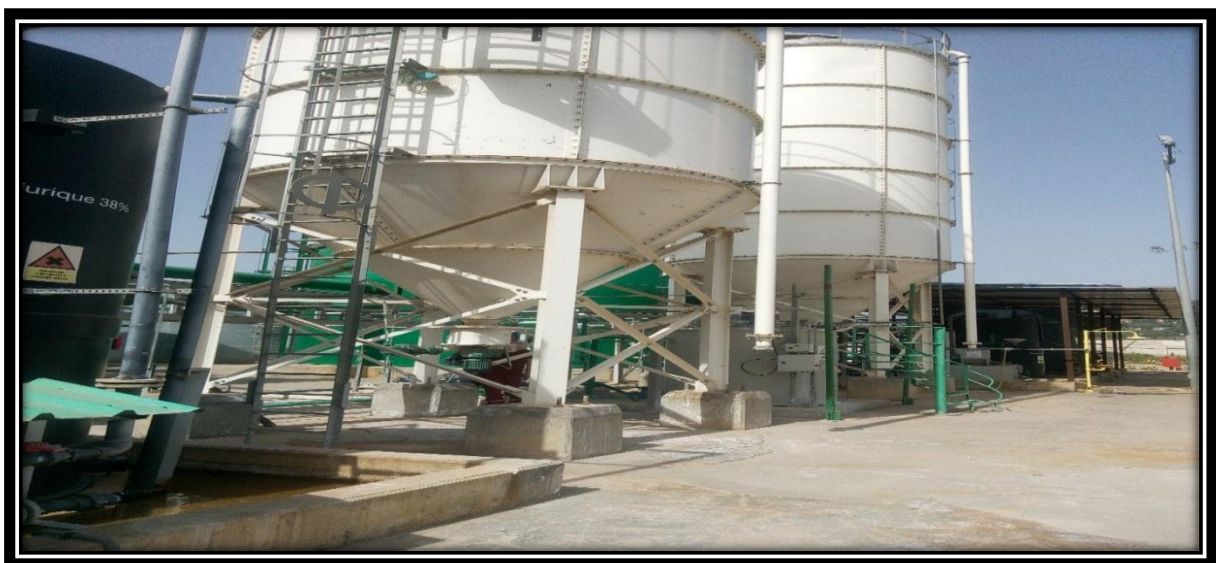
Fig.24. La chambre de décarbonatation
