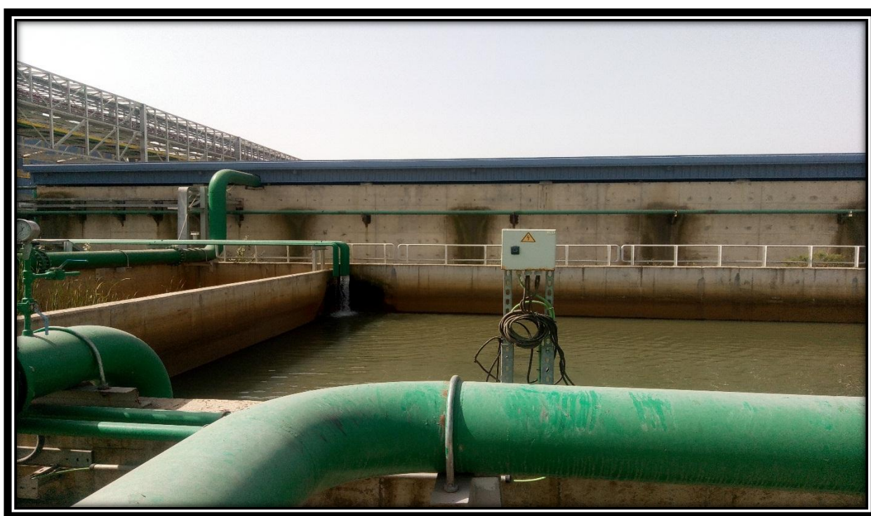
Fig.38. Le bassin de réduction chimique des eaux usées
