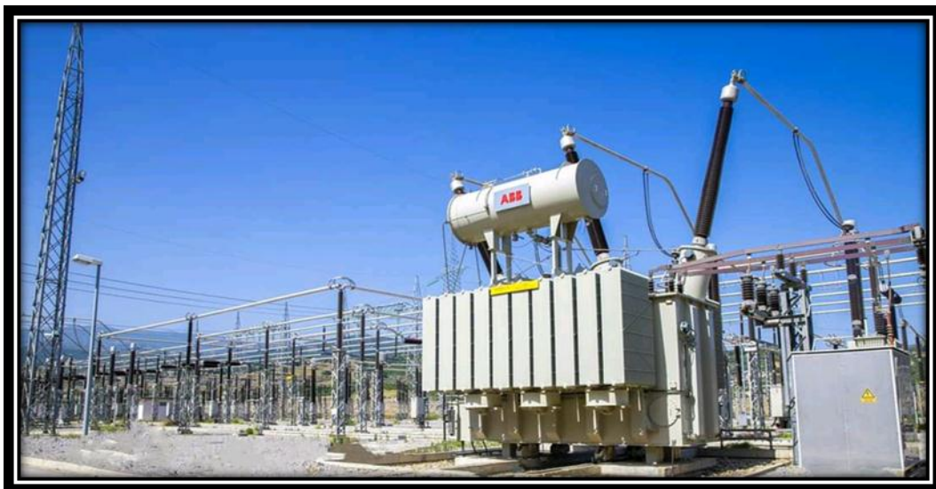
Fig.16. Sous-station électrique (MRSS) [3]
