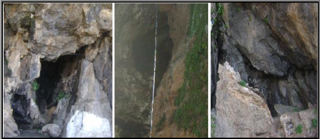
Figure IV.11 : Cavités au niveau de la route PK 25+450 sur RN 43 (Ghar El Baz)
