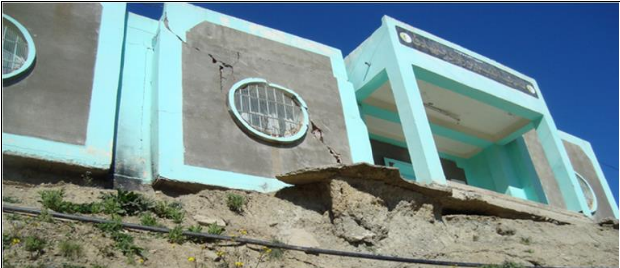
Figure III.7 : Fissures et dégradations importante de la structure de la maison de jeunes
