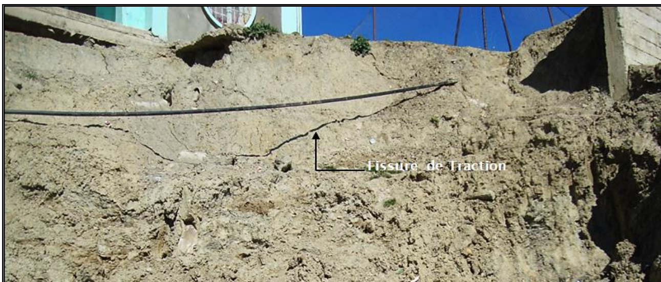
Figure III.8 : Fissures de traction sur le talus en question
