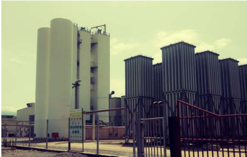
Figure I-4. Unité de séparation d'air.
