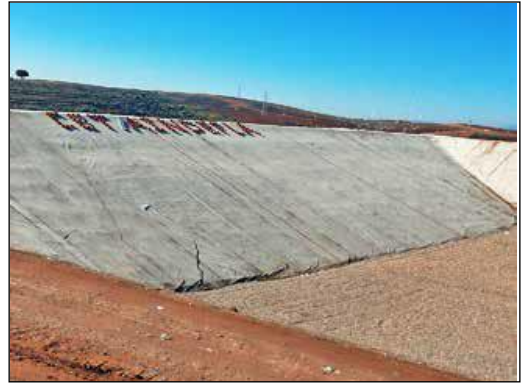
CET en exploitation à Ain Defla
