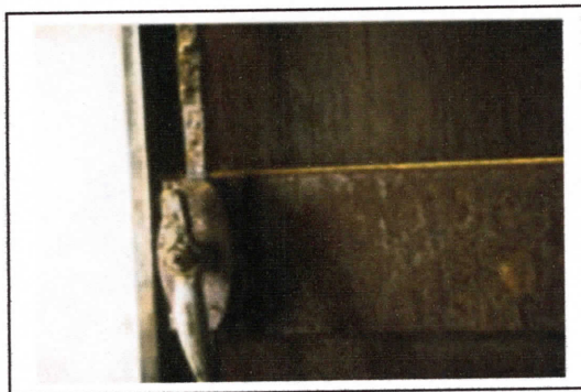
Figure (I.5) : Corrosion d'une porte en acier dans une atmosphère soufrée.
