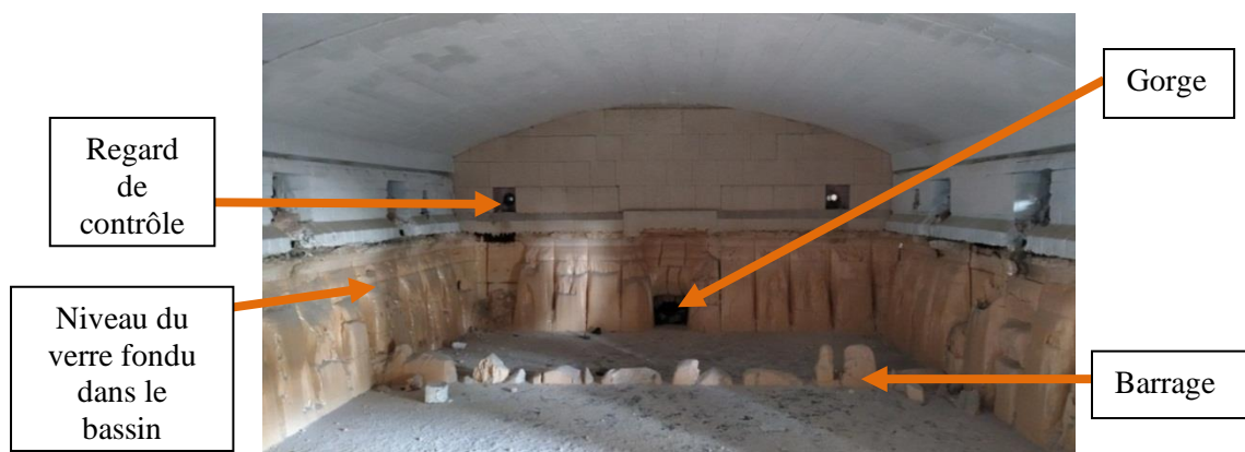
Figure I.10 Vue côté opposé aux brûleurs
