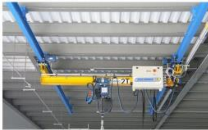
Figure I.5 : Un pont roulant suspendu.
