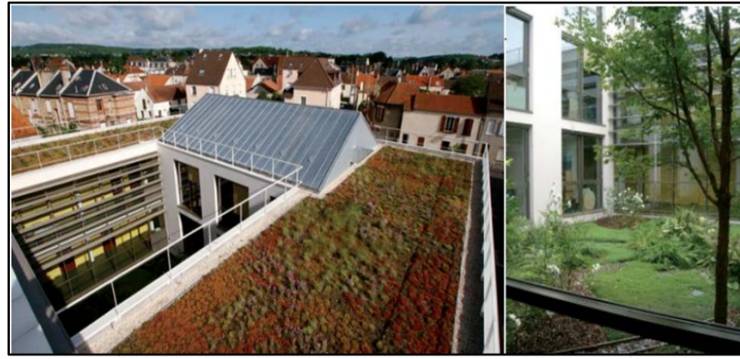
Figure 17 : Vue sur la toiture végétalisées et les habillages des édicules techniques en toiture inclinée depuis la partie supérieure en gravillonné (Source : Ekopolis, 2010).
