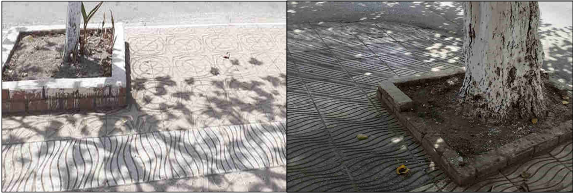
Photo 4.6. La dégradation des pavées et les différents trottoirs
