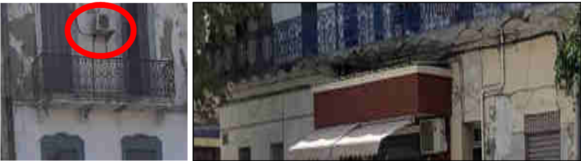
Photo 4.17. Vieillessement et écaillage des enduits de façade sur la réalité
