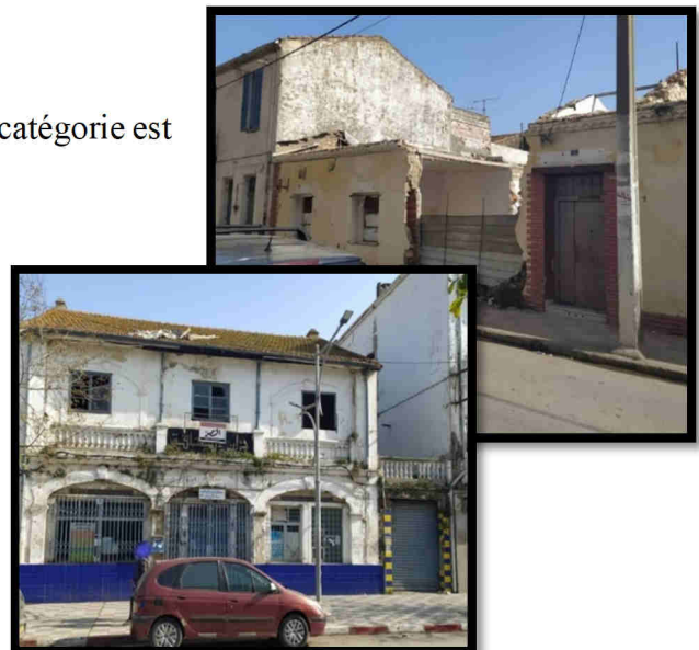
Photo 3.4. Vue sur une Construction en mauvais état Source : auteur2021
