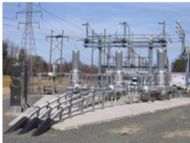
Figure I.25: Câble supraconducteur LIPA (600 MW, 600 M, 138 KV), en 2008 à paris « source : https://www.nexans.fr/eservice/France-fr »
