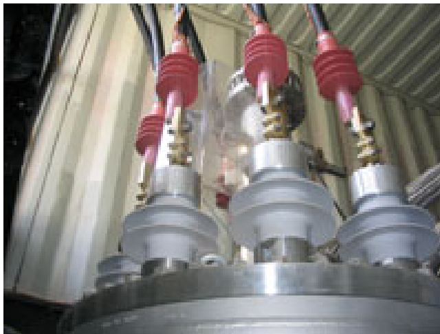
Figure I.26 : Le limiteur de courant de défaut supraconducteur ( LCDS ) avec composants Nexans est mis en ligne sur le réseau RWE en 2004 à paris.
