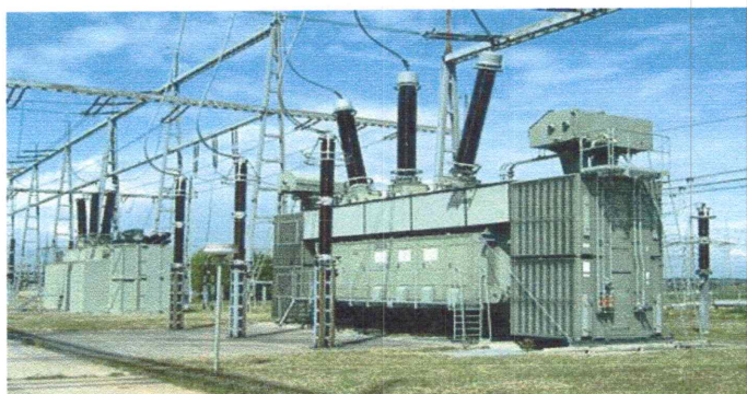
Figure I.1 Transformateur de puissance dans un poste d'interconnexion
