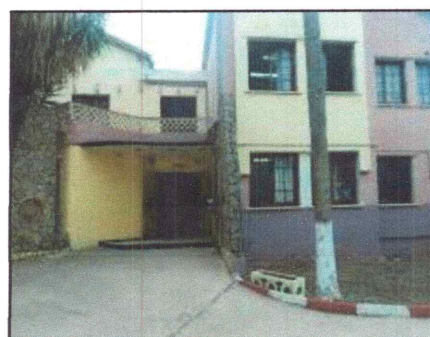
Figure-I- 25 : CMP à Douaouda
