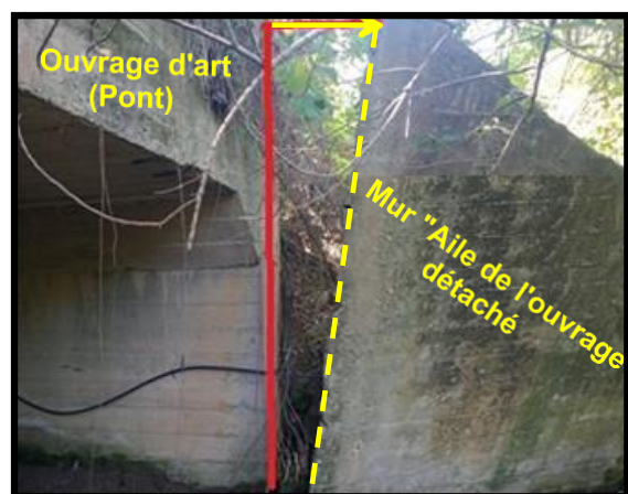
Figure I.30 : Détachement du mur « Aile d'ouvrage »
