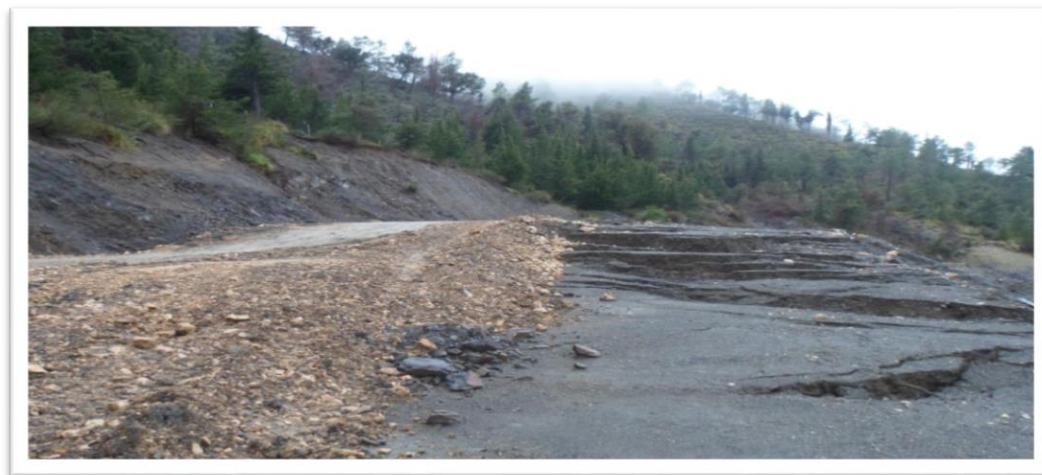
Fig. IV-12. Escarpements sur les tas de remblais
