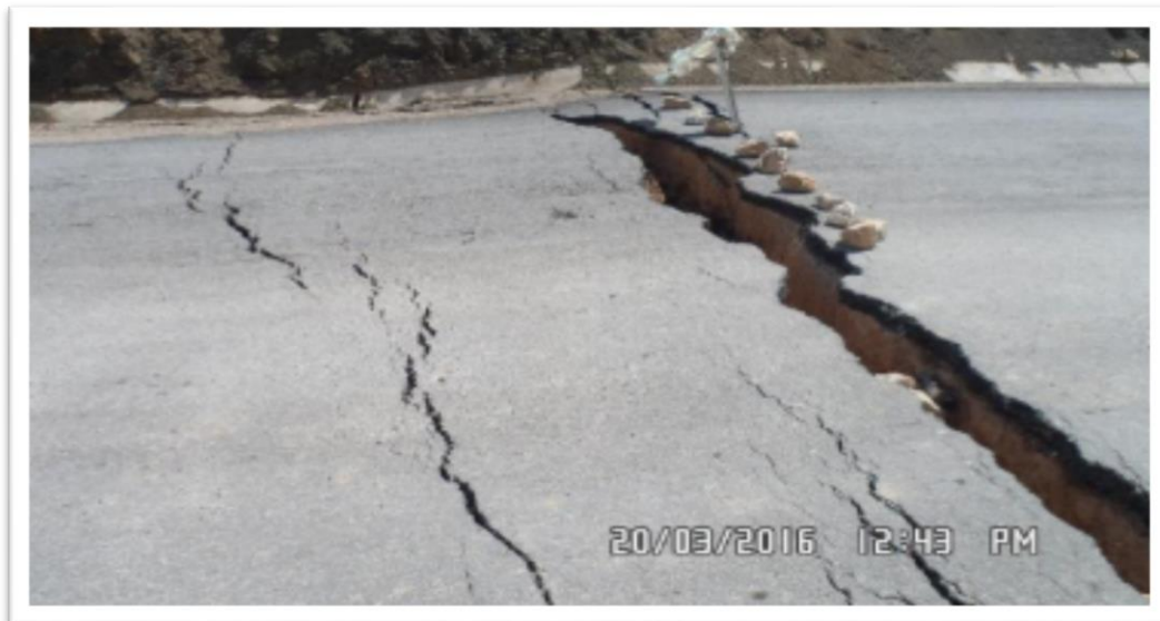
Fig. IV-11. Fissures de traction sur la chaussée
