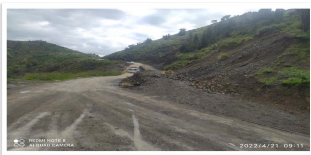
Fig. IV-13. Tassement total de la chaussée
