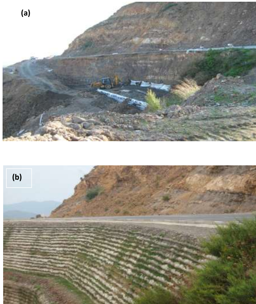
Figure 1.20 : réalisation d'un remblai renforcé : (a) phase de réalisation ;(b) forme finale du remblai
