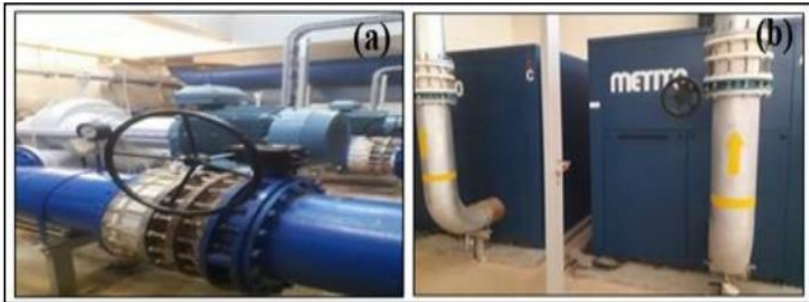
Figure 2.11 : Lavage des filtres, (a) : Pompe ; (b) : Souffleurs
