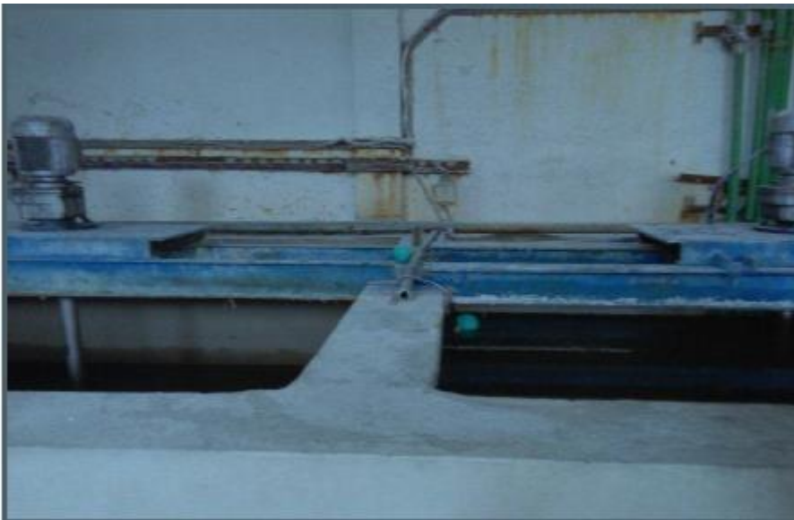
Figure 3.12 : Bac de préparation d'adjuvant
