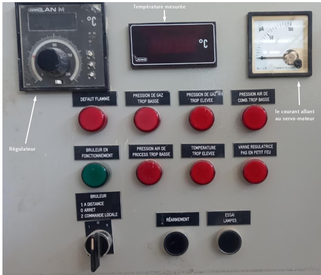
Figure 1.30. Armoire électrique du brûleur
