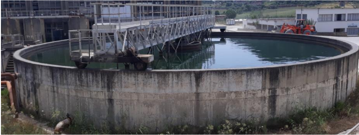
Figure 1.15. Le réservoir équipée d'un mélangeur
