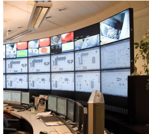
Figure 2.10. Salle de contrôle avec SCADA
