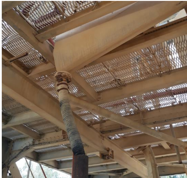
Figure 1.10. Le tuyau allant vers le filtre
