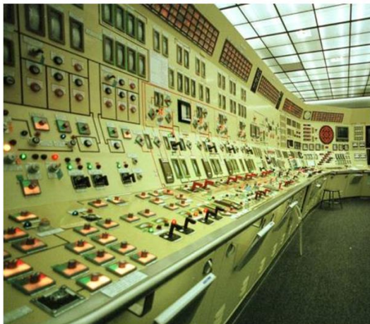
Figure 2.9. Salle de contrôle sans SCADA
