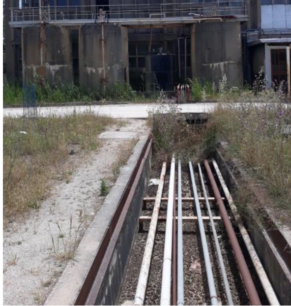
Figure 1.18. Les tubes de transport allant aux mélangeurs
