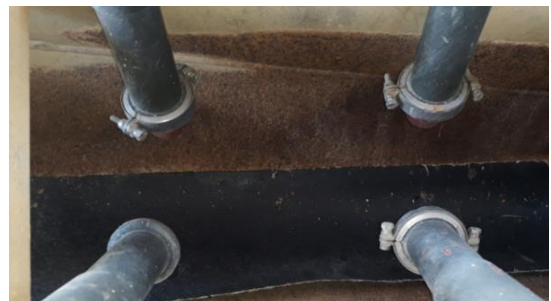
Figure 1.9. le bout du tuyau
