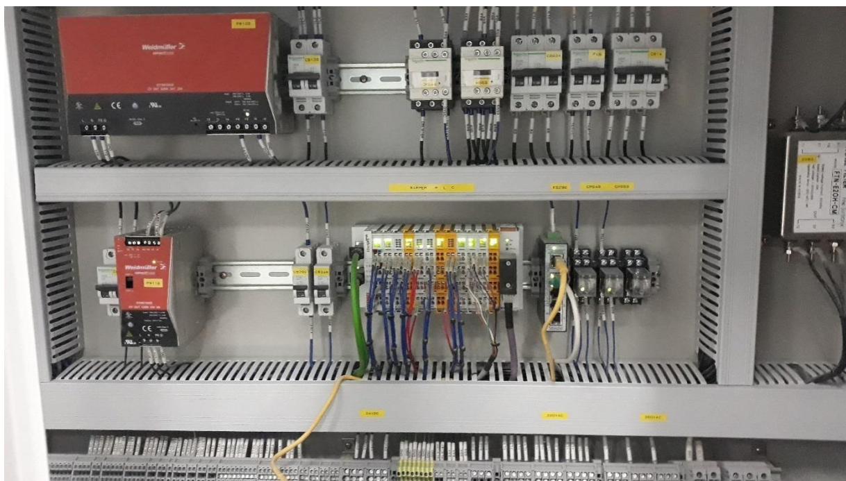
Figure 11 : Armoire électrique du Tambour « Automate »[1]
