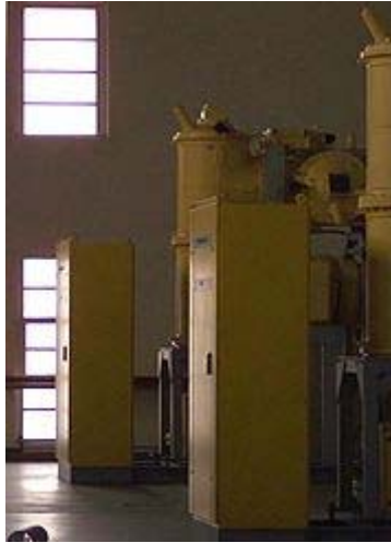
Figure I.3 Poste électrique haute tension isolé au SF 6 [2].
