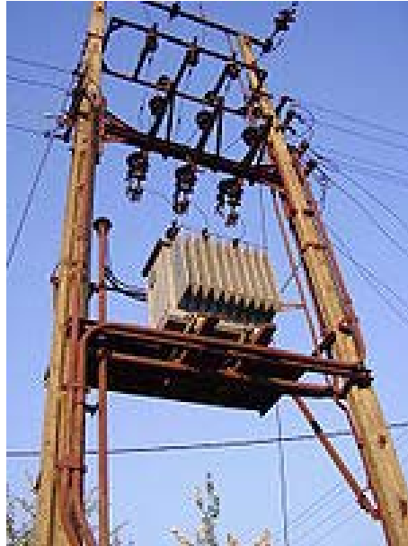
Figure I.1 Un petit transformateur MT/BT
