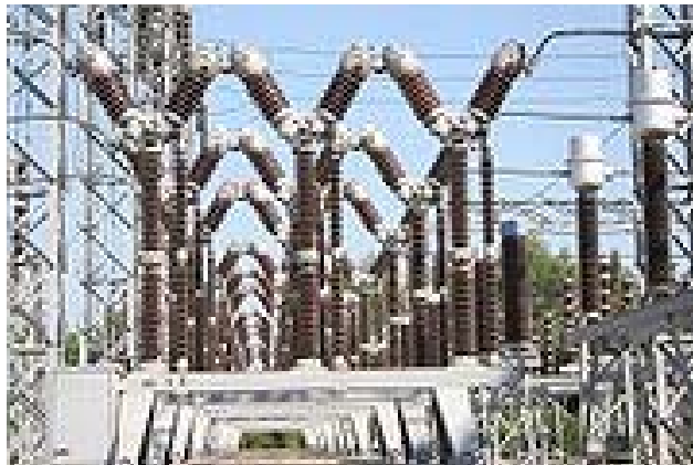
Figure I.2 Poste électrique haute tension isolé à l'air [2].
