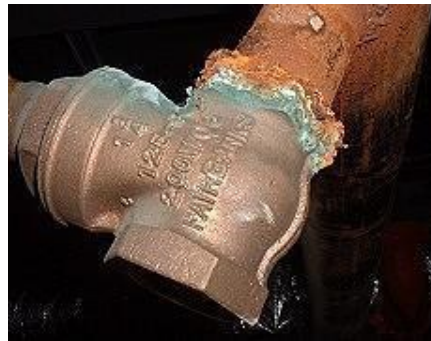
Fig. II 10 : Corrosion galvanique résultante d'un assemblage de deux métaux différents : robinet en cuivre et conduite en acier galvanisé [9].
