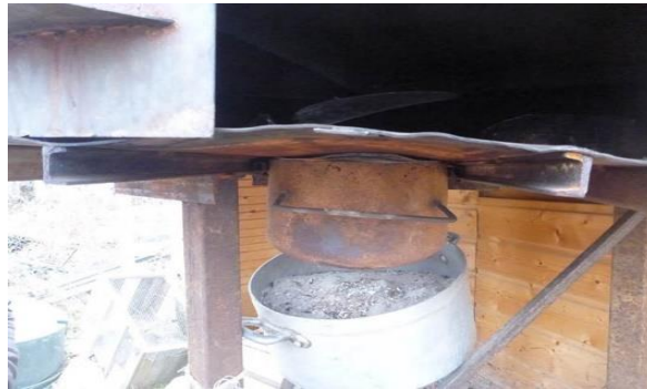
Fig. II 2 : exemple illustratif de corrosion
