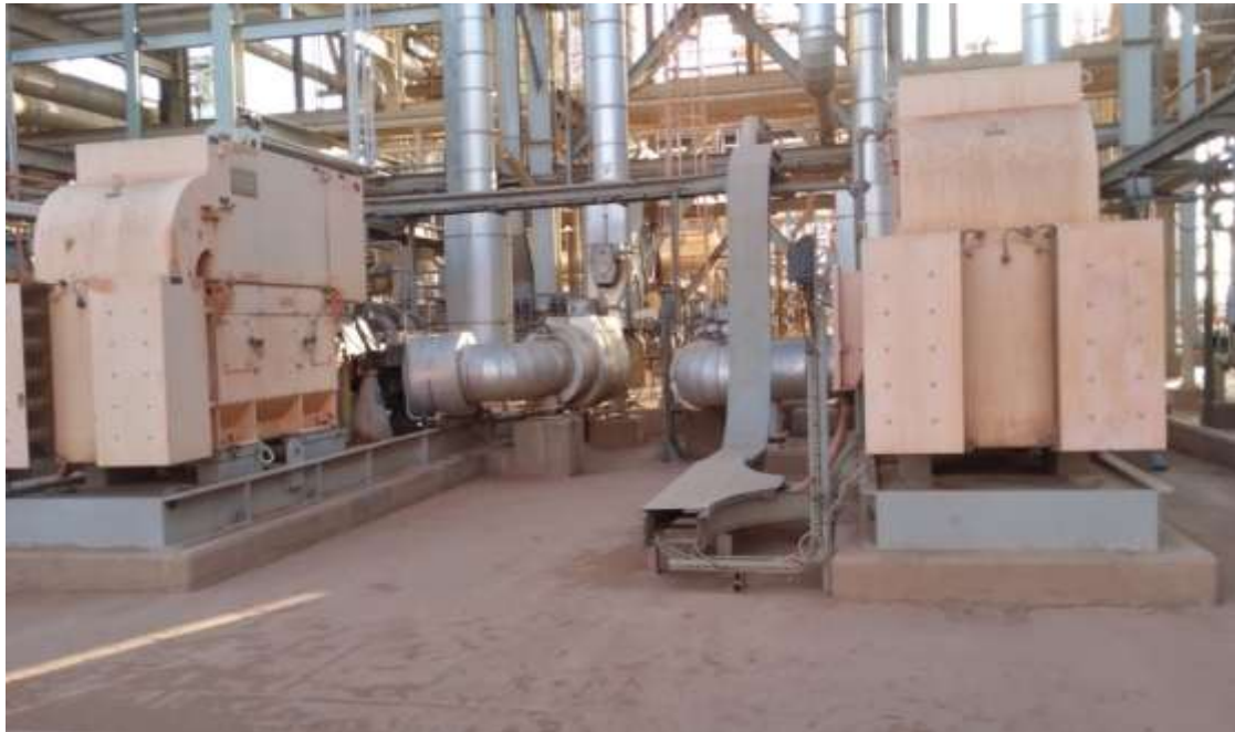
Figure III.10 : Pompes Booster D'amine Pauvre P-113A/B
