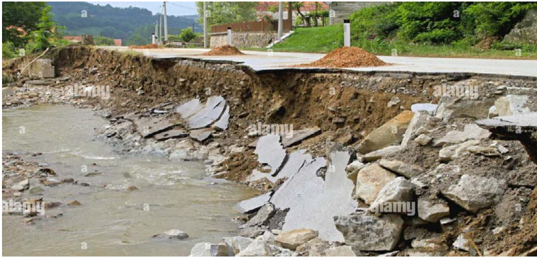
Fig.17. Erosion de la route après les inondations
