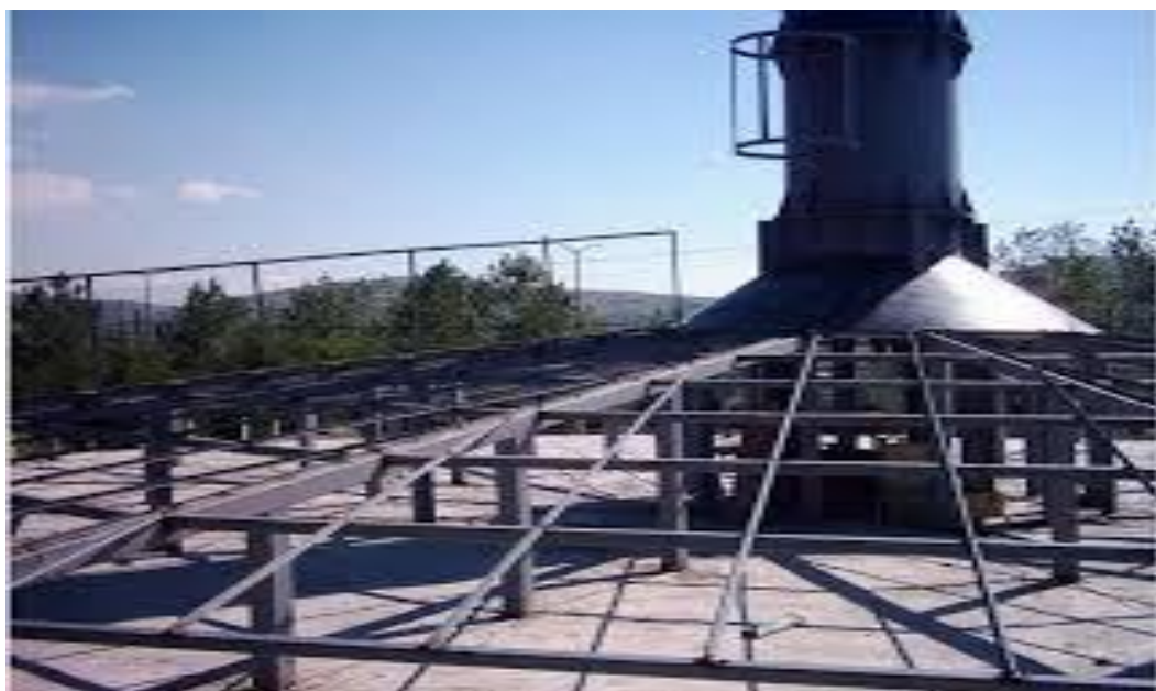
Fig. I.3. Verrière du collecteur d'une cheminée solaire [3]
