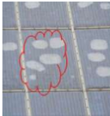
Figure 1.7. Défaut de délaminage [11].
