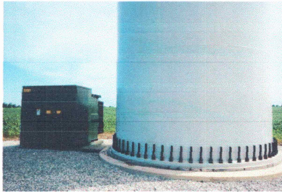
Figure II.14 : Armoire de couplage au pied d'une éolienne.
