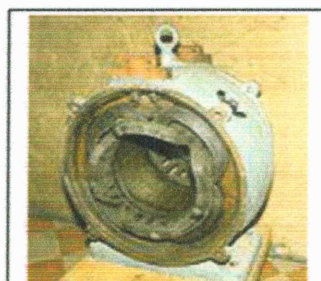
Le stator, 4 paires de pôles. Les deux borniers de raccordement.
