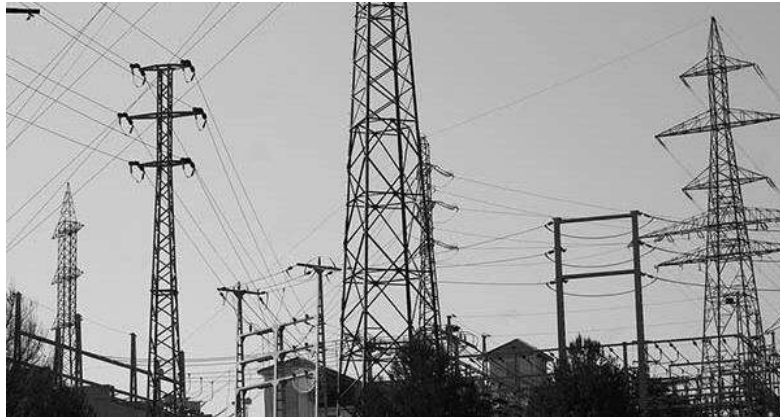
Figure I.1. Lignes électriques aériennes.
