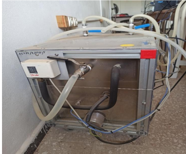
Figure II.2. Générateur de vapeur au niveau du laboratoire énergétique, université de Jijel
