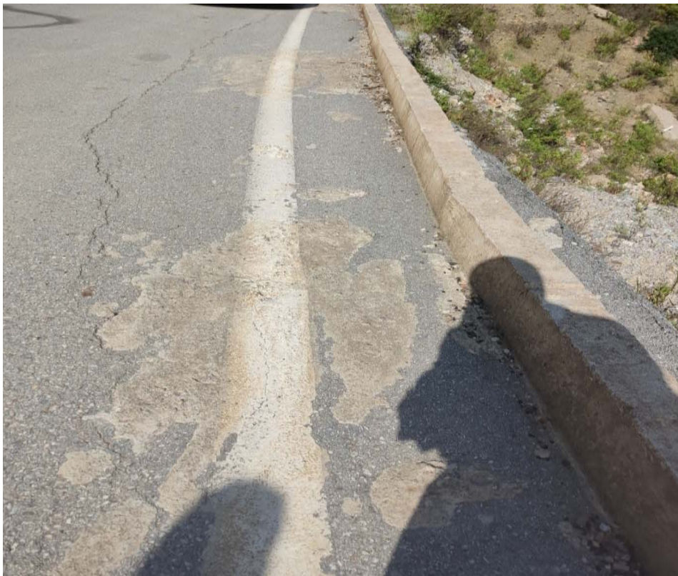
Photo II.2. Fissures dans un béton bituminé
