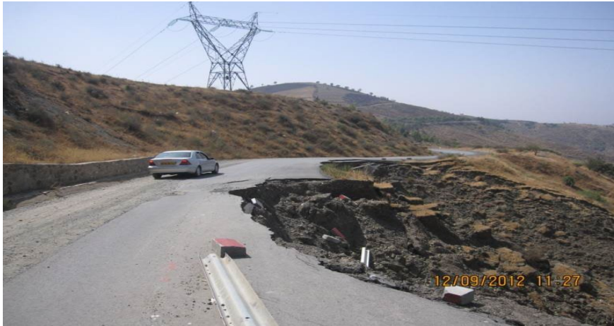
Photo. I.3. Cas du glissement de terrain au niveau de Bouira
