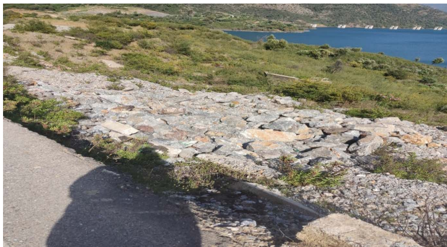
Photo. II.1: effondrement et escarpement principal au cœur de la chaussée
