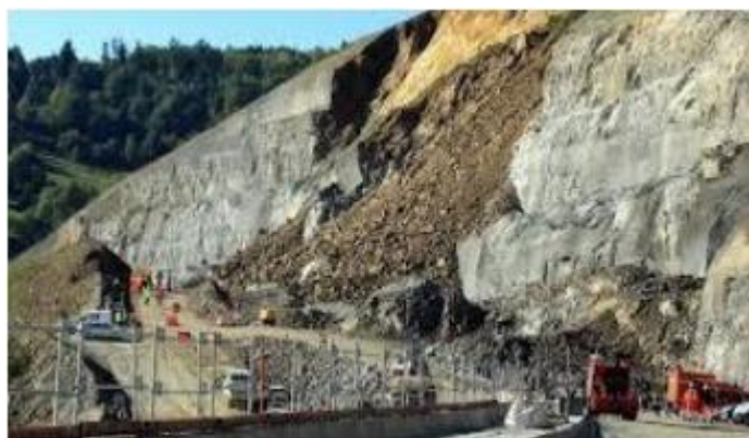
Figure I.17: Glissement à cause des travaux de déblais (Chantier de A 89 Rhône, France, 2011). [19]
