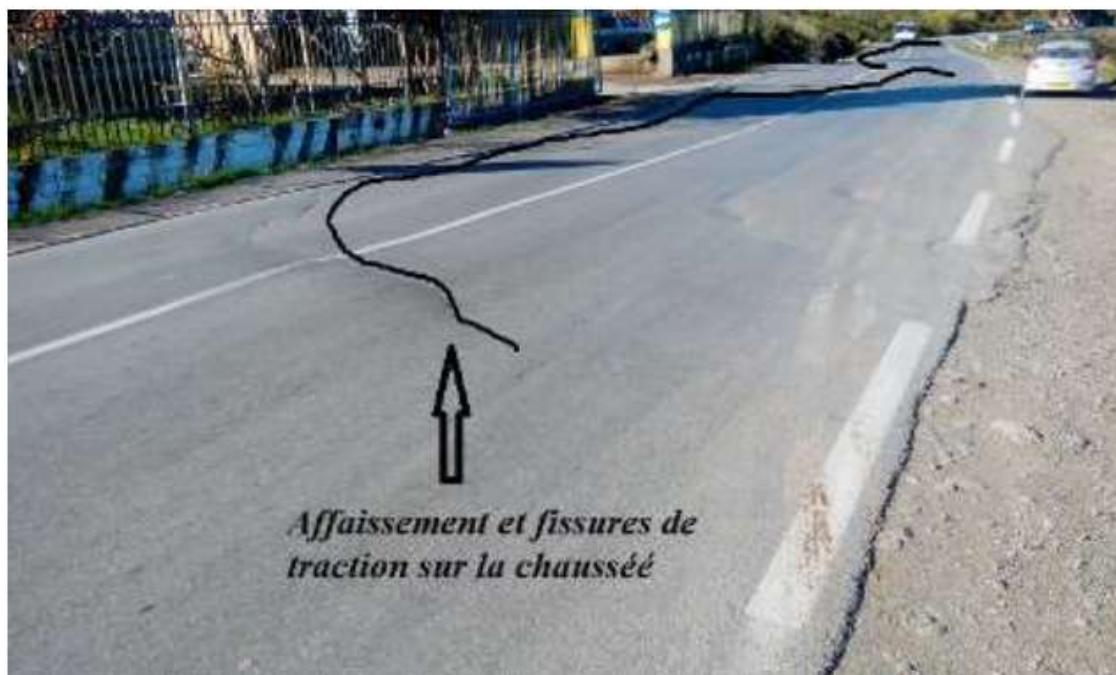
Figure III.05: Affaissement et fissures de traction le long de la chaussée sur 170m de linéaire.
