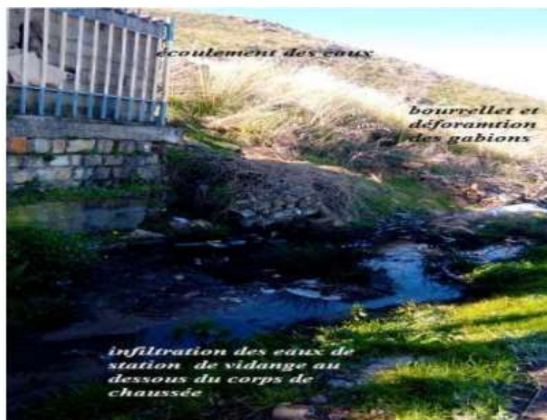
Figure III.13: Désordres de l'instabilité du talus côté amont avec stagnation d'eau.
