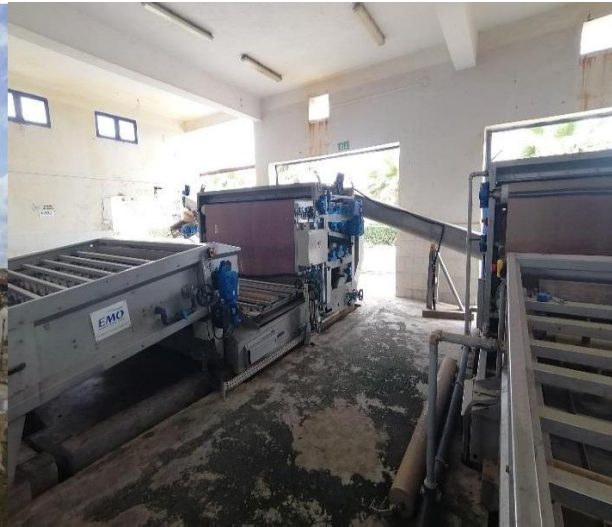
Figure II.16 : déshydratation mécanique des boues
