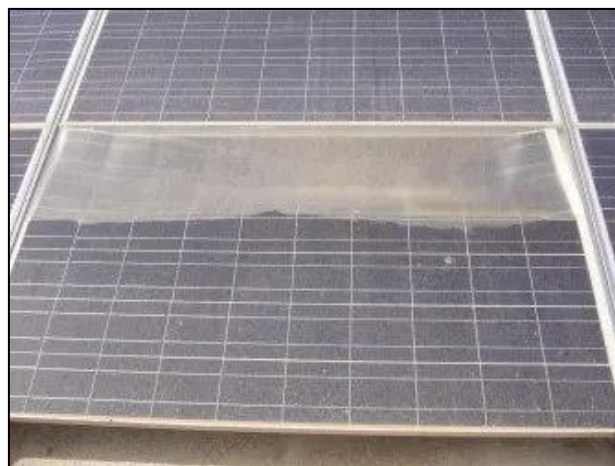
Figure 1.5. Défaut de délaminage
