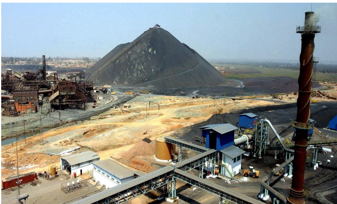
Figure 54 : Installation des caniveaux dans un site minier (le secteur minier fer de lance du Katanga, la république démocratique du Congo) (source : RDC: Le secteur minier, fer de lance du Katanga – Africotelegraph – Toute l'actualité africaine )
