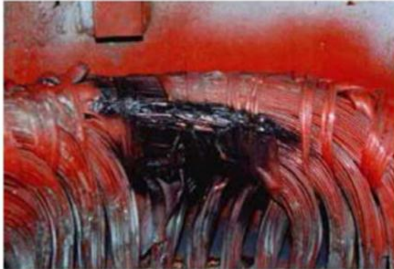
Figure III.4: Défaut de court-circuit entre spires
