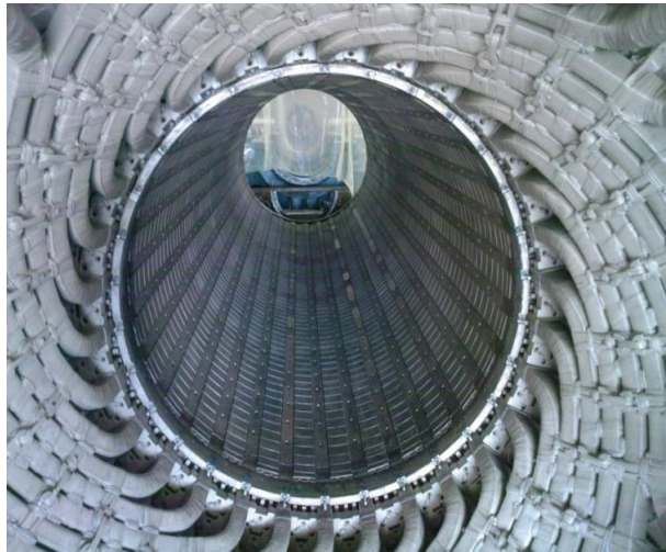
Figure I.5 : Enroulement du TIB-200-MT3 (alternateur de la centrale thermique de Jijel).
