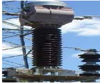
Figure II-2 Transformateur de courant
