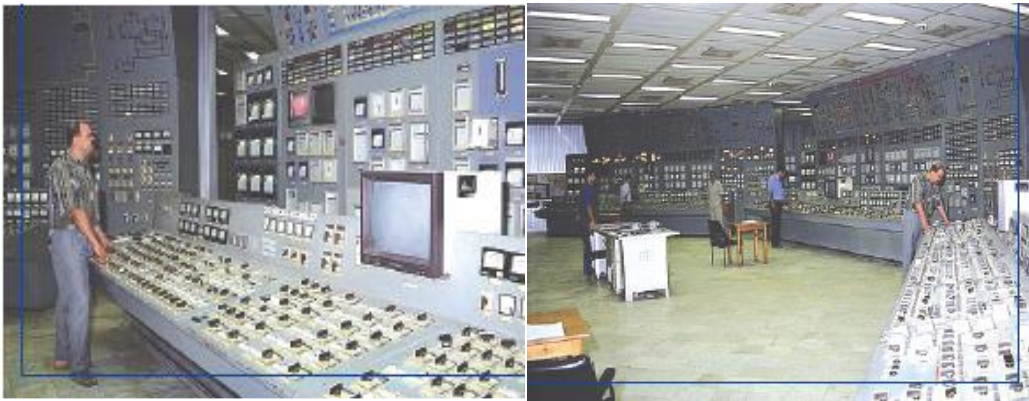
Figure IV-1 salle de commande centrale de production Achouat
