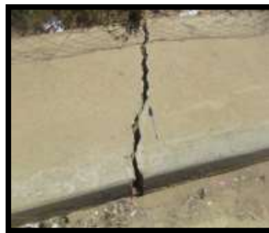
Photo.09.Fissure sur la construction de glissement de terrain
