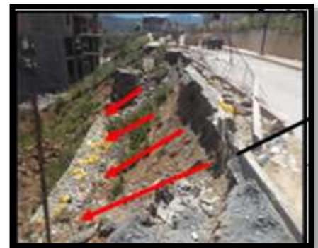
Photo.10 .Arrachements du glissement de terrain
