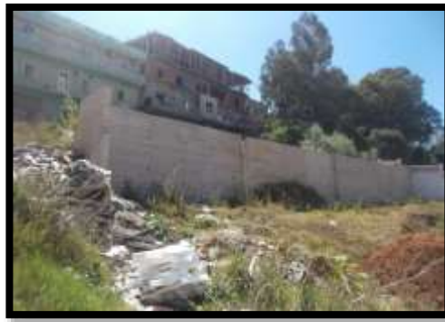
Photo.07. Inclinaison du mur soutènement à citer Boukaabour -Taher
