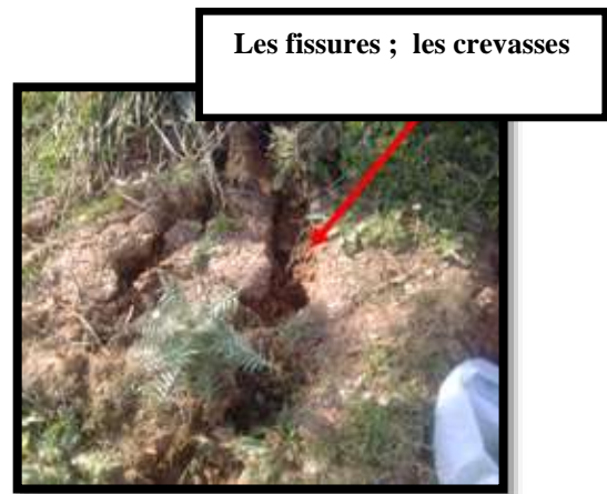
Photo .02. Fissures et des crevasses de 10 à 20 cm d'ouverture environ
