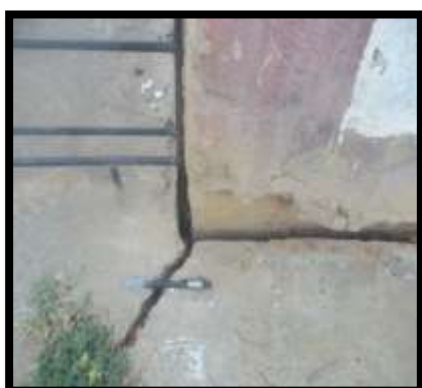
Photo. 03 .fissures dans les constructions glissement de terrain à la cite 200 logts
