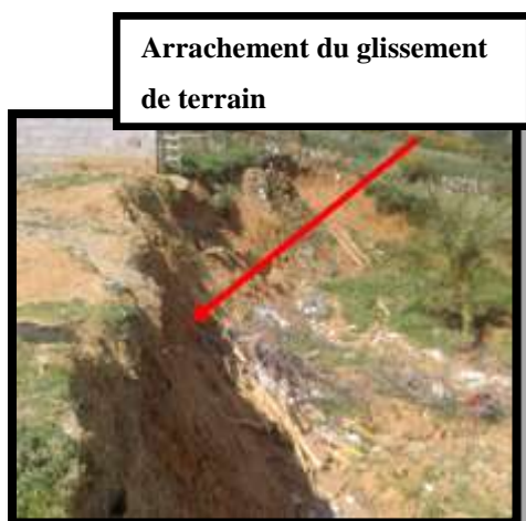
Photo.01. dépôt anarchique des matériaux d'apport (remblais).
