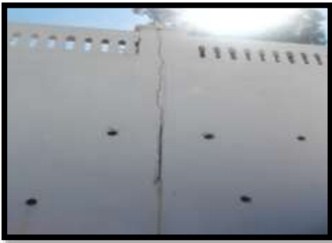
Photo.06. fissures dans les constructions à cité Boukaabour -Taher
