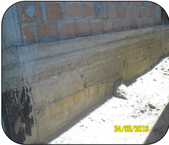
Figure II.12 : Des fissures sur les longrines des fondations.
