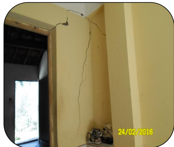
Figure II.11 : Des fissures apparus sur les murs de la maison.
