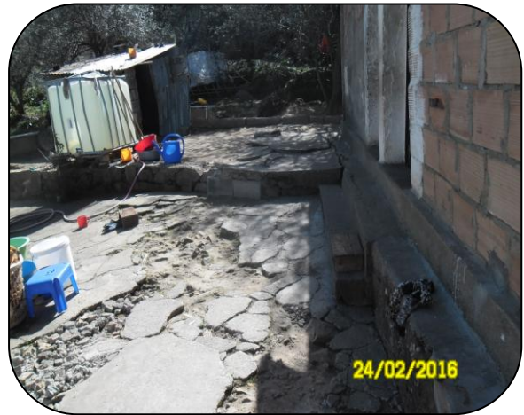
Figure II.13 : Affaissement et détérioration des plates formes autour des maisons.
