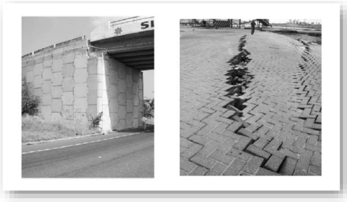
Figure II.16 : (gauche) Résistance d'un ouvrage terre-armée après un séisme de magnitude 7,5 à Tecoman au Mexique en 2003 – (droite) Etat d'un quai du port de Tecoman.
