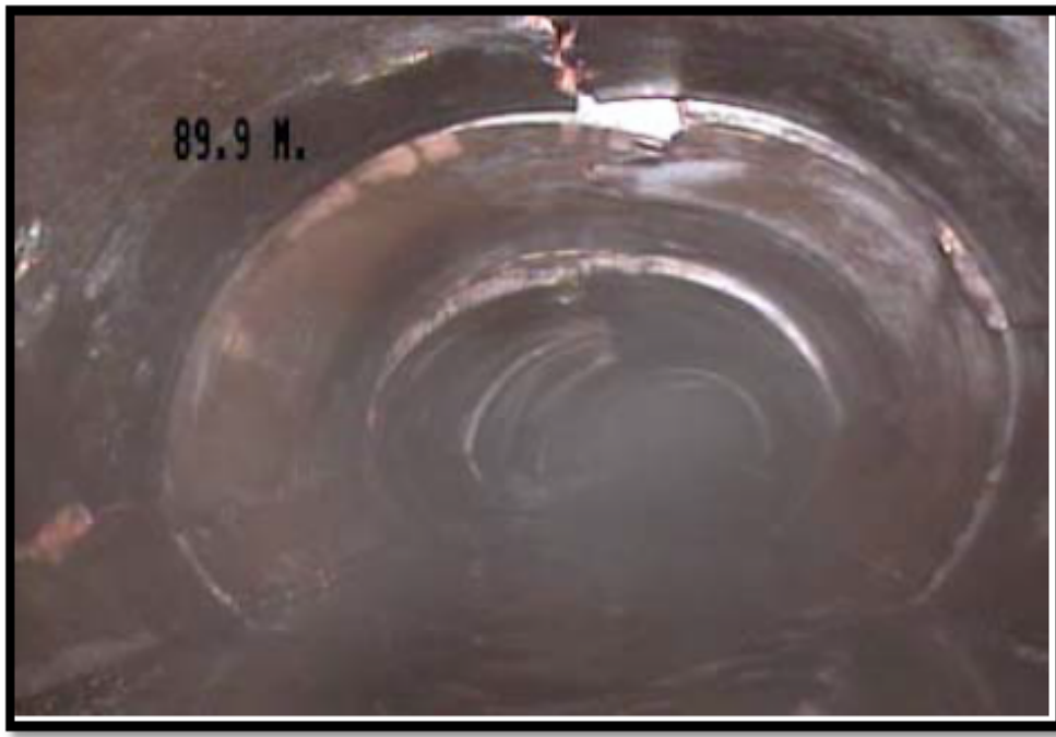
FIGURE 1.13 – Exemple d'une conduite Déformée.
