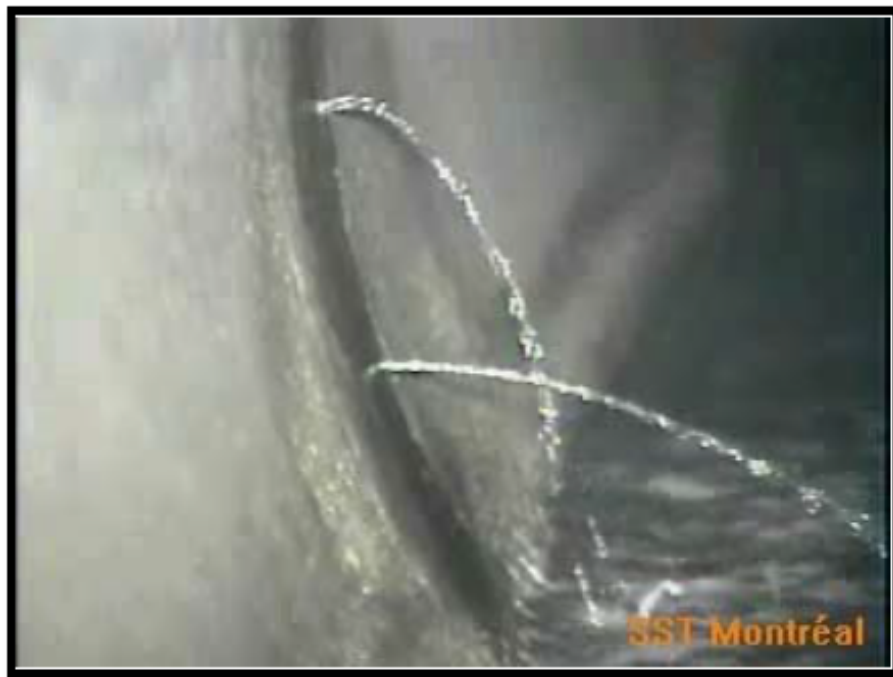
FIGURE 1.9 – Exemple d'une infiltration à travers un Joint non étanche.
